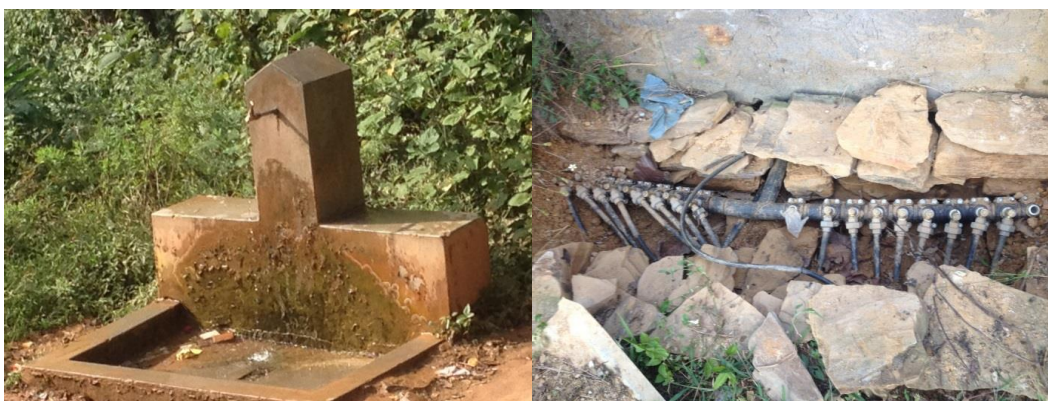
Constructions de 2015 : Point d'eau de l'école et système de distribution d'eau au village Sont donc approvisionnés en eau grâce à ce nouveau réservoir
